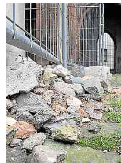
Der Turm des Mahnmals St. Christoph zeigt Risse.
